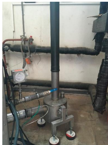
Figure 7. Sección de tratamiento de gases.
